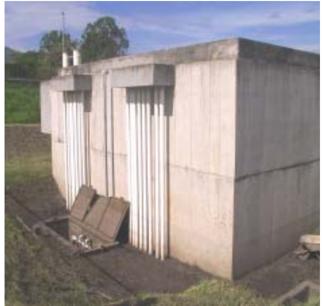
Reactor anaerobio de flujo ascendente. Urbanización Bosques de Santa Ana, San José, Costa Rica. Fotografía tomada por unidad Aguas residuales del AyA, Costa Rica
