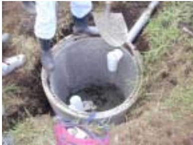
Tratamiento preliminar. Trampa de grasas y partículas gruesas
