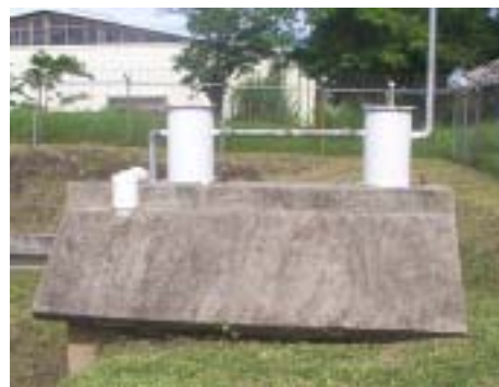
Biodigestor para lodos en planta para el tratamiento de aguas residuales en Urb. Bosques de Santa Ana, San José, Costa Rica. Fotografía tomada por unidad Aguas residuales del AyA, Costa Rica
