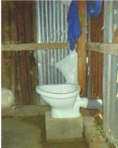
Letrina en losa sanitaria con sello de agua. Conectada a fosa séptica. Fotografía tomada por Ing. Elías Rosales
