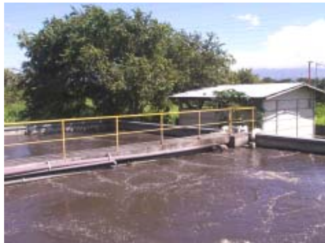
Unidades de lodos activados. Urbanización Lagos de Lindora, San José, Costa Rica. Fotografía tomada por unidad Aguas residuales del AyA, Costa Rica
