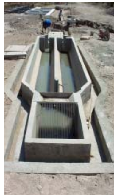
Pre-tratamiento (rejillas y desarenador), Santa Ana del Norte, El Salvador; foto cortesía de Julián Monje.
