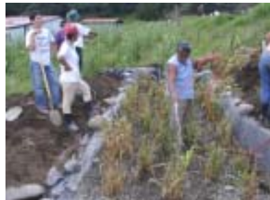
Plantas colocadas sobre el lecho filtrante
