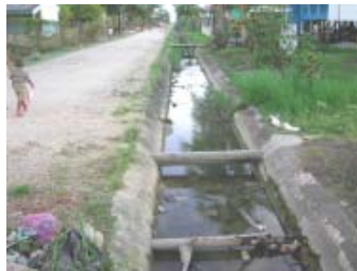
Este canal de drenaje, en Bocas del Toro, Panamá, tiene conexiones ilícitas de aguas servidas sin tratamiento
